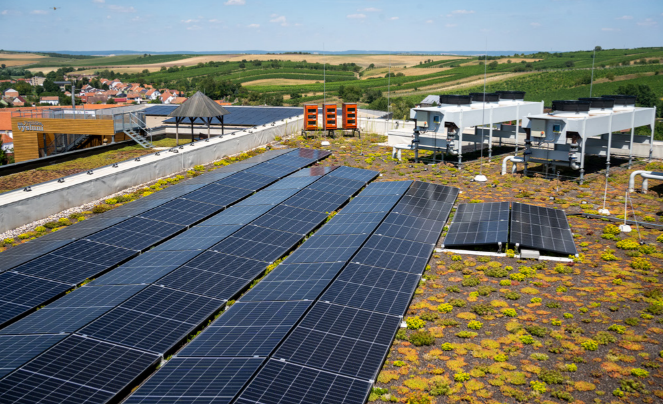
Na budově Solis jsou nainstalovány celkem tři fotovoltaické elektrárny, největší je o výkonu 146 kWp
