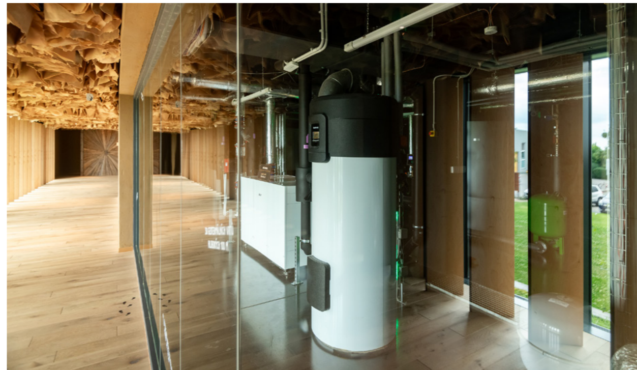
Tepelné čerpadlo v interiéru haly
