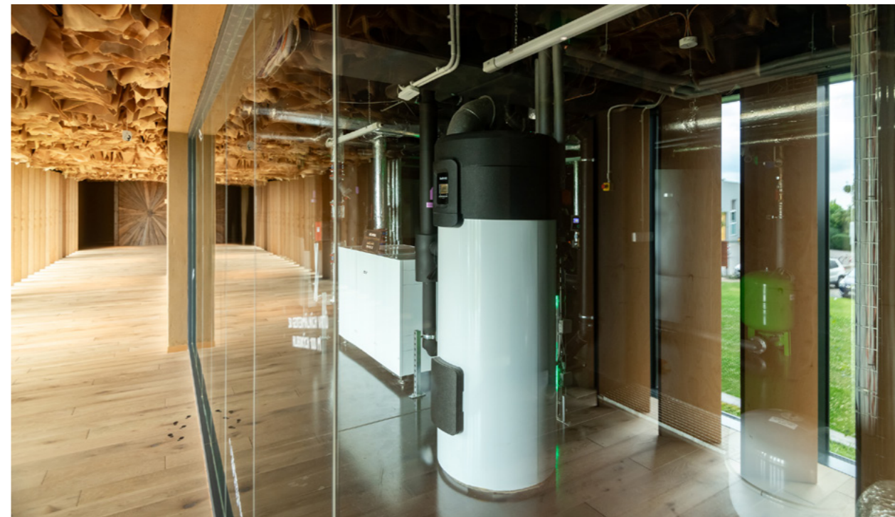
Tepelné čerpadlo v interiéru haly
