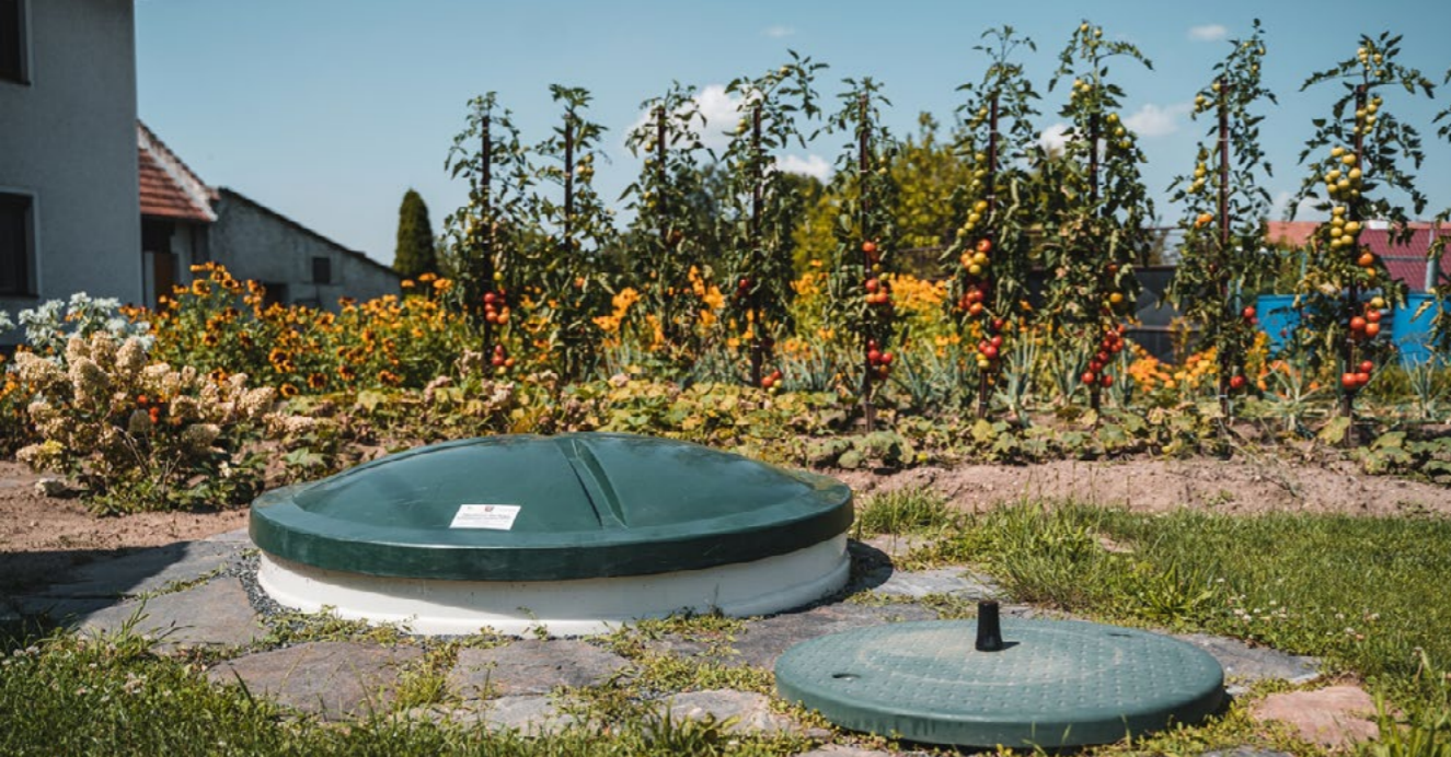
Umístění čistírny na zahradě rodinného domu – víko umožňuje snadný přístup.
