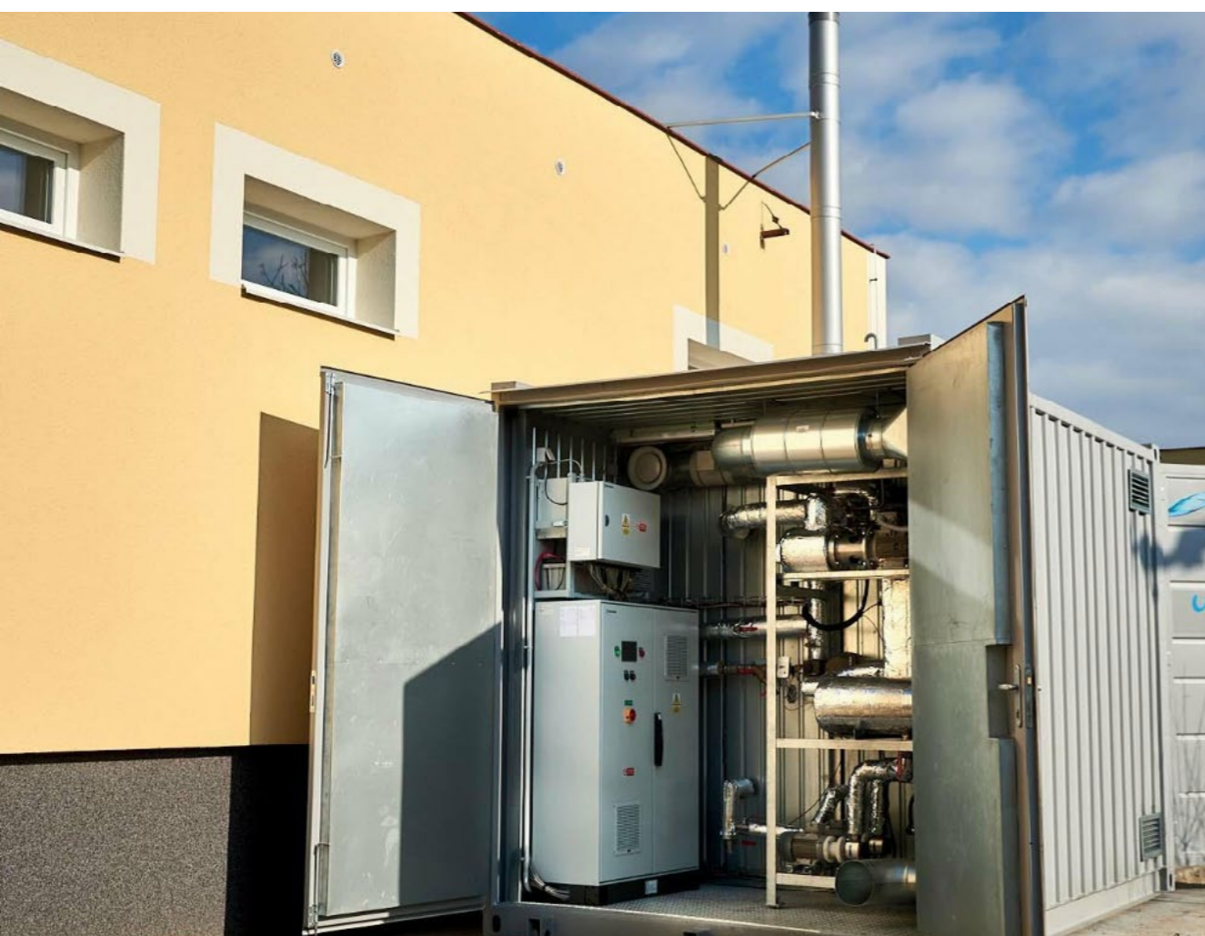
Kogenerační kotel a záložní zdroj v jednom v Mikolajicích. (Foto: archiv obce)
