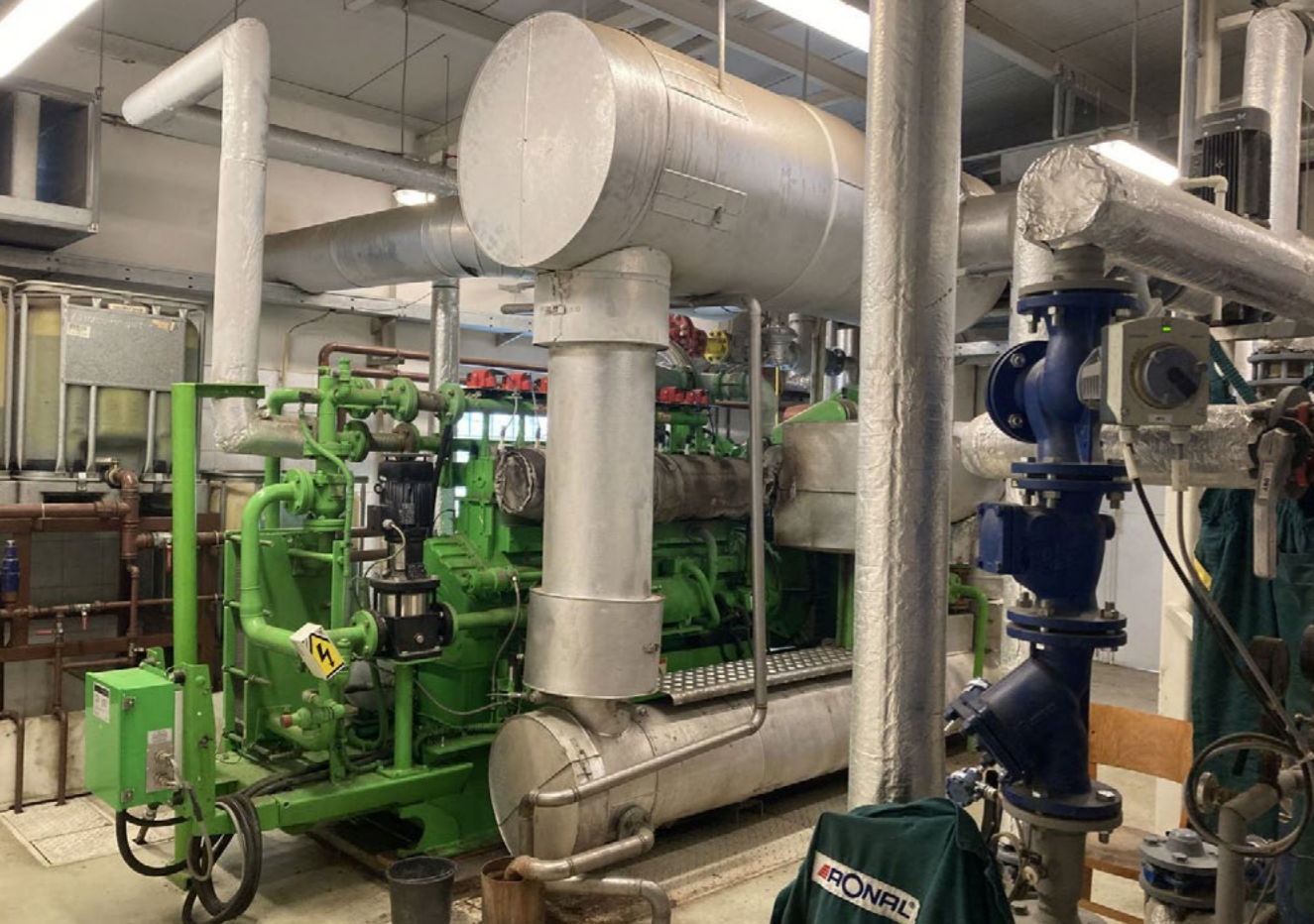
Kogenerační jednotka s elektrickým výkonem 330 kW.
