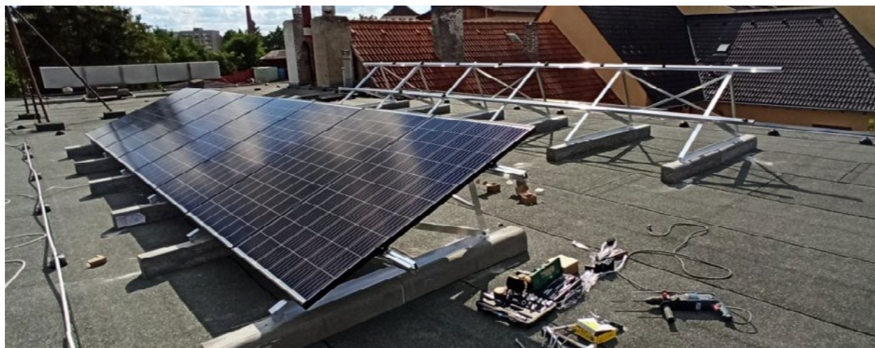
Při montáži FVE hrozí prošlapání tepelné izolace a poškození povlakové hydroizolace konstrukcí, nářadím.
