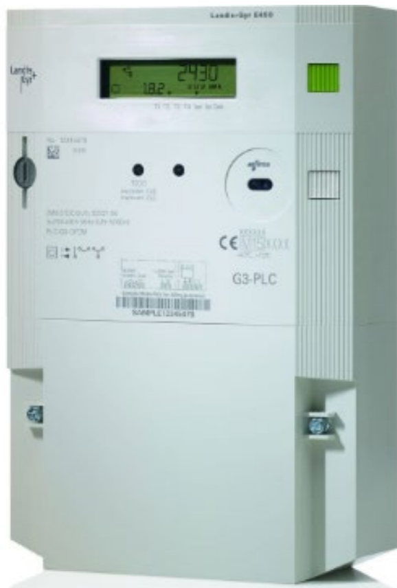
Chytrý elektroměr E450 Landis+Gyr s komunikací PLC instalovaný ve Starovicích.
