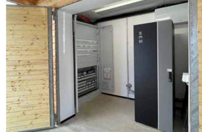
Bateriová stanice HES je od září 2021 instalována i v inteligentním rodinném domě v Omicích u Brna.
