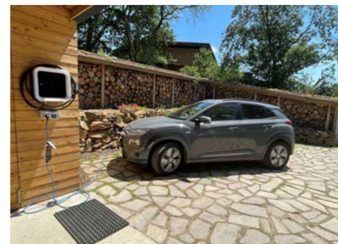
Elektřina z FVE na střeše dodává elektrickou energii přímo tam, kde je potřeba. Může nabíjet akumulátory a zároveň vykrývat spotřebu objektu. Nebo nabíjí elektromobil majitele domu.
