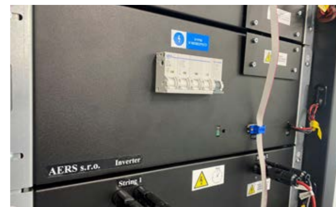
Detail stanice HES s vestavěným měničem.
