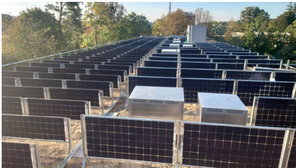
Vertikálně uspořádané moduly fotovoltaických panelů na zelené střeše, Mattenbachstrasse 2, Winterthur. Půdorys . (Foto a půdorys: archiv Andreas Dreisiebner)
