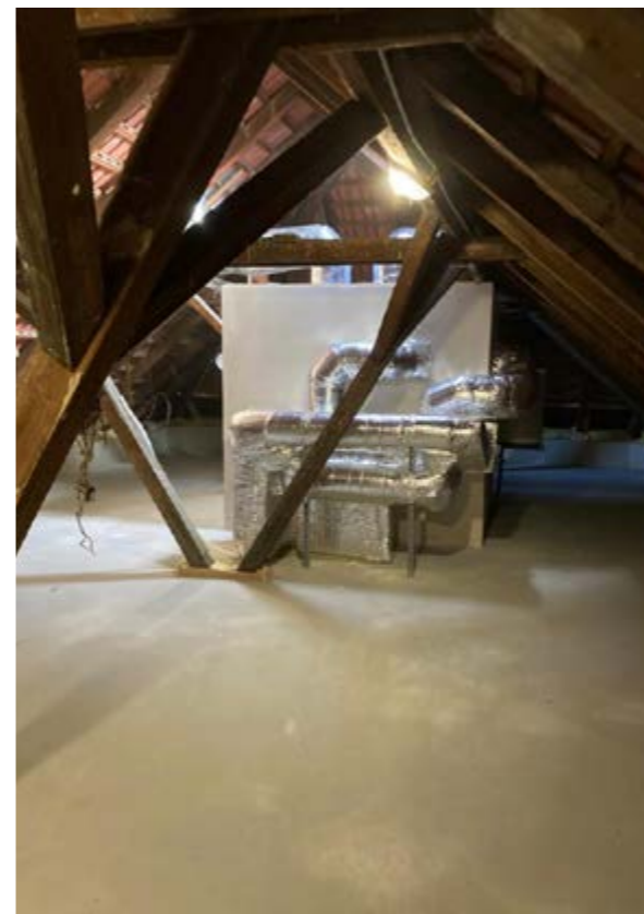
VĚTRÁNÍ: Větrací jednotka na půdě a v kotelně.
