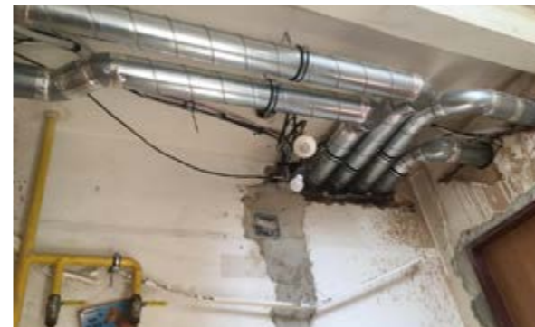
VZT: Rozvody vzduchotechniky na chodbě a půdě.
