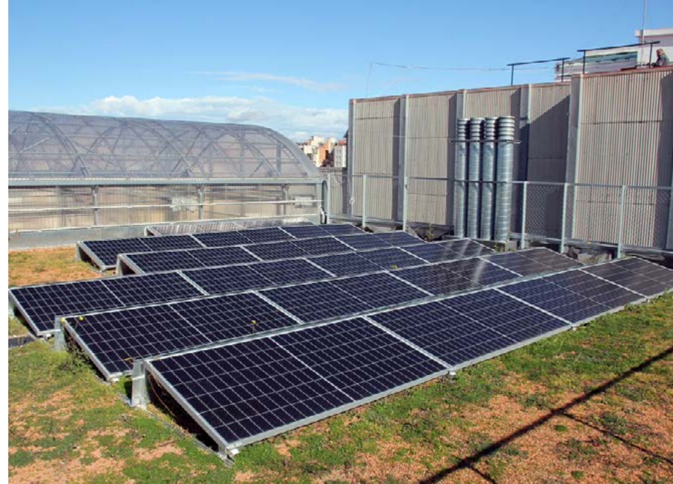
Dvacítka fotovoltaických panelů produkuje čtvrtinu veškeré potřebné energie.
